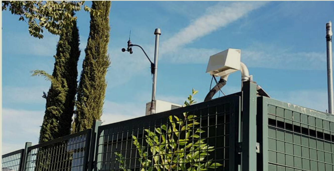
Instalación de anemómetro y de sensores para monitorizar la calidad del aire.
